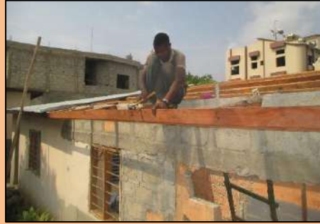
Réalisation des travaux de construction des toitures de la salle de réunion par l'ouvrier Jacob Akpo.
